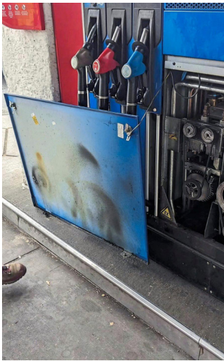
Eine Zapfsäule war defekt und rauchte.
